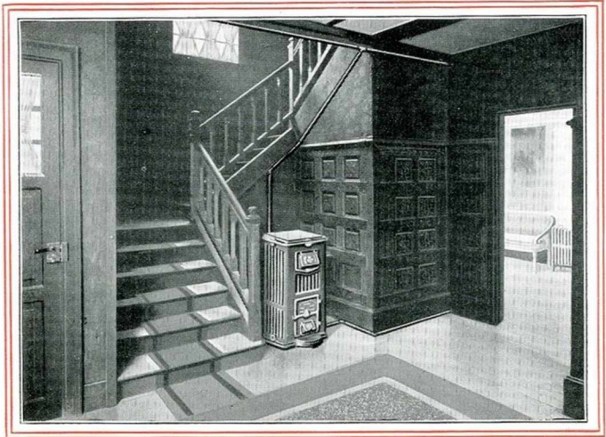
Chaudière "IDÉAL CLASSIC" installée dans un vestibule.
